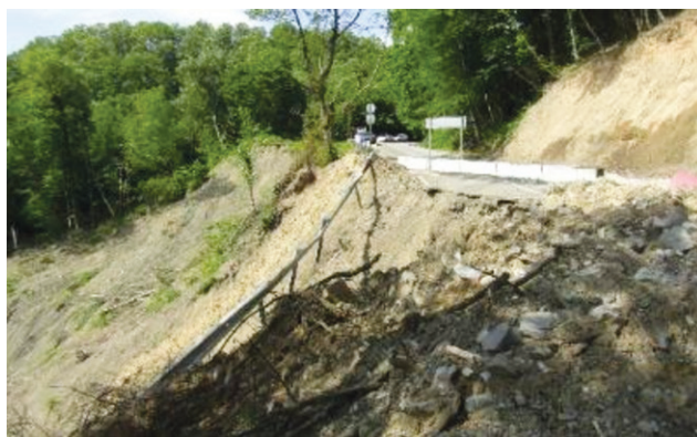
Рис. 1. Оползневая активизация с разрушением дорожного полотна отрезка автодороги 03К-453 у северной окраины с. Измайловка (фото ЮРЦ ГМСН «Гидроспецгеология»)
