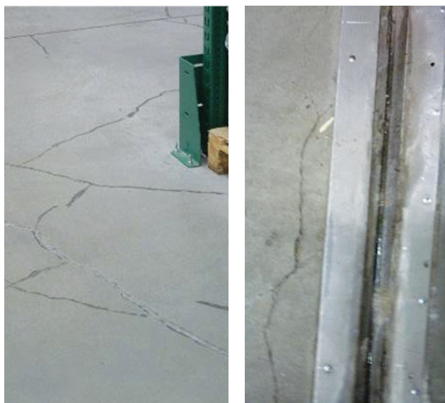
Рис. 1. Усадочные и деформационные трещины
