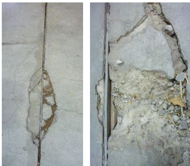
Рис. 2. Отслоение и разрушение упрочненного покрытия
